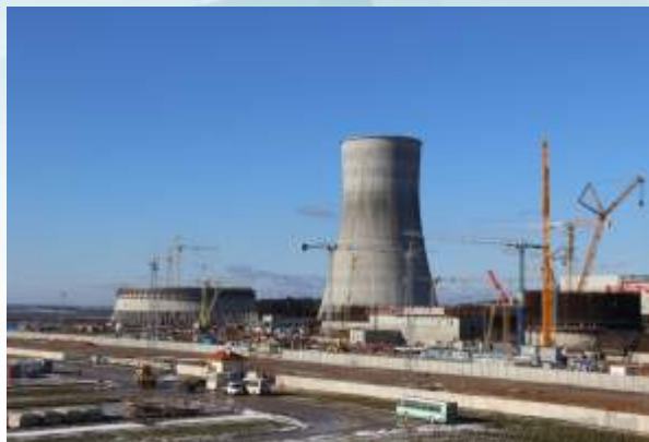
«Белорусская атомная станция», г. Островец, РБ
